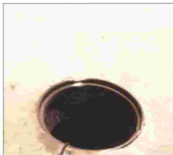
FOSAS PARA INSPECCIÓN
